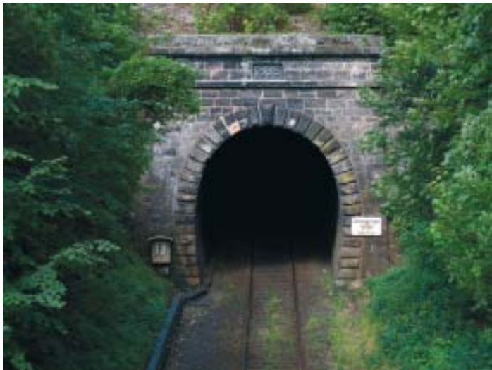
Tunnelportal des baufälligen alten Zierenberger Tunnels, der durch einen Neubau ersetzt wird
